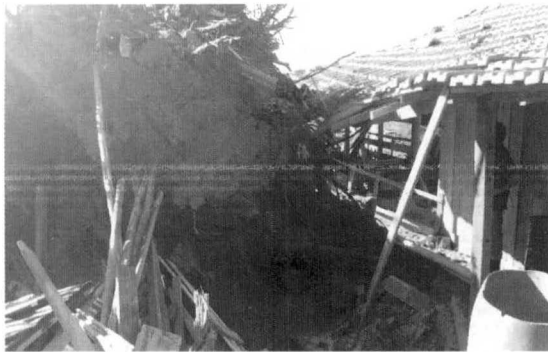
Casa de produtor rural destruída pelo vendaval
